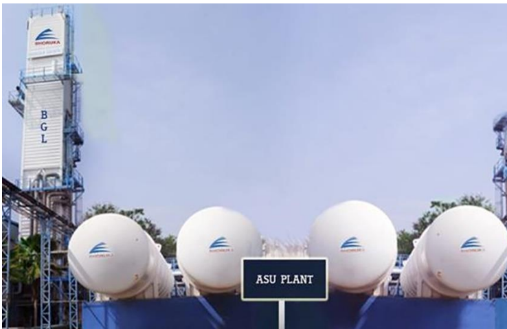
Impianto di Frazionamento Aria
